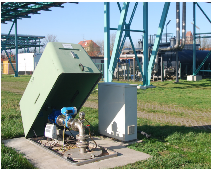
Brunnenriegel Bitterfeld | Brunnenkopf eines Einzelbrunnens
