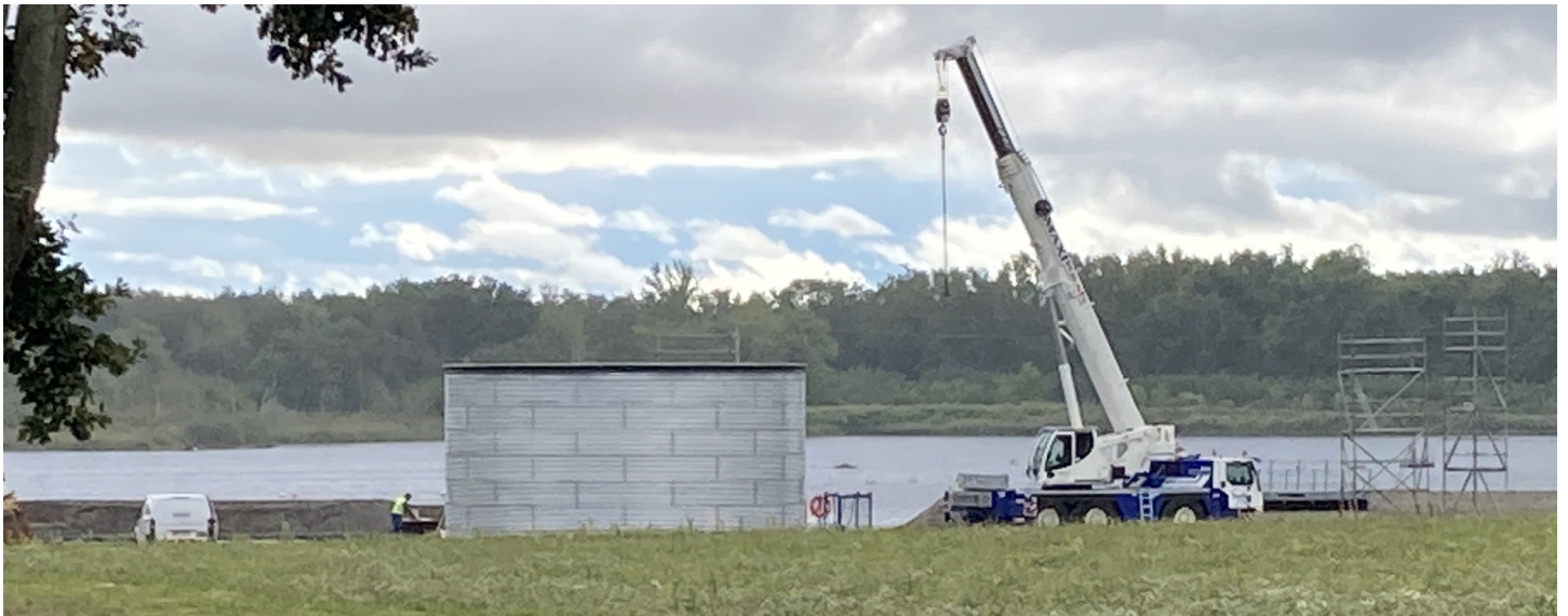
Deponie „Grube Johannes“ | Tankbehälter zur Belüftung
